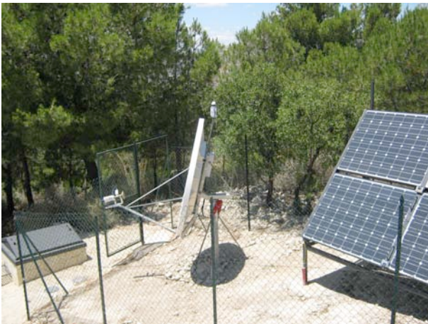
Figura 1. Installazione della stazione di Favara (FAVR) in provincia di Agrigento.
