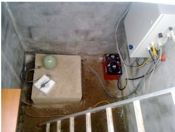
Figura 2. Vista interna del vano sensore/strumentazione del sito di Paolisi (PAOL).
