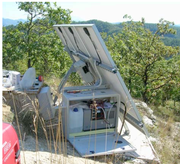
Figura 4. Sito di Poggio Castellaccio (ATPC). Esempio di installazione di EFOY Pro 1600 a supporto dei pannelli solari.
