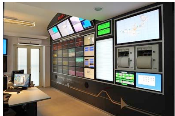
Figura 3. Sala operativa di Catania.
