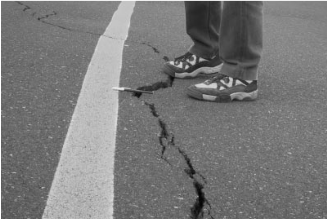
Foto 1.9b Effetti di fagliazione superficiale cosismica lungo la faglia S. Tecla. Località Mortari.
