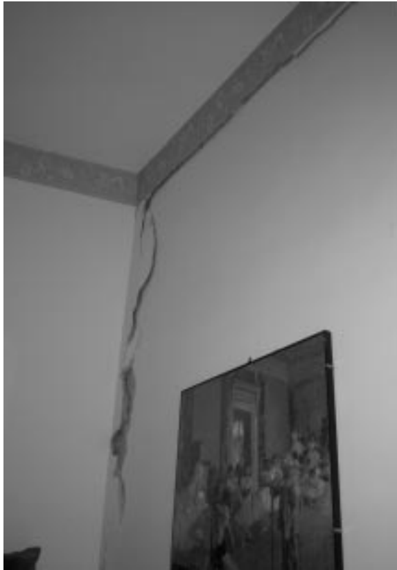
Foto 1.7 S. Maria Ammalati: distacco del prospetto principale di un edificio in muratura di classe B (dichiarato inagibile).
