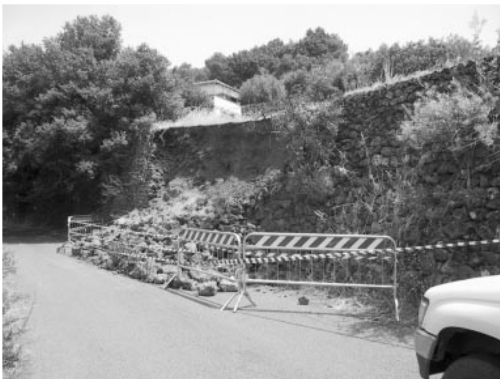
Foto 1.6 Contrada Boschetto: crollo muro a secco lungo la strada provinciale SP 4.
