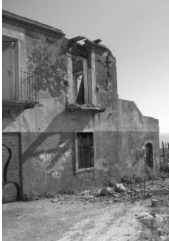
Foto 1.8 Mortari: crollo parziale di un edificio di classe A già fortemente danneggiato da terremoti precedenti.
