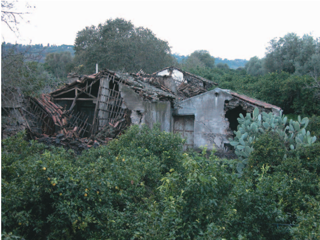
Foto 1.11 Scillichenti: crollo parziale di un edificio rurale (cl. A).
