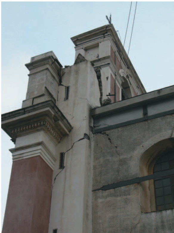
Foto 1.9 Bongiardo: danni gravi al campanile della Chiesa di Maria SS. del Carmelo.
