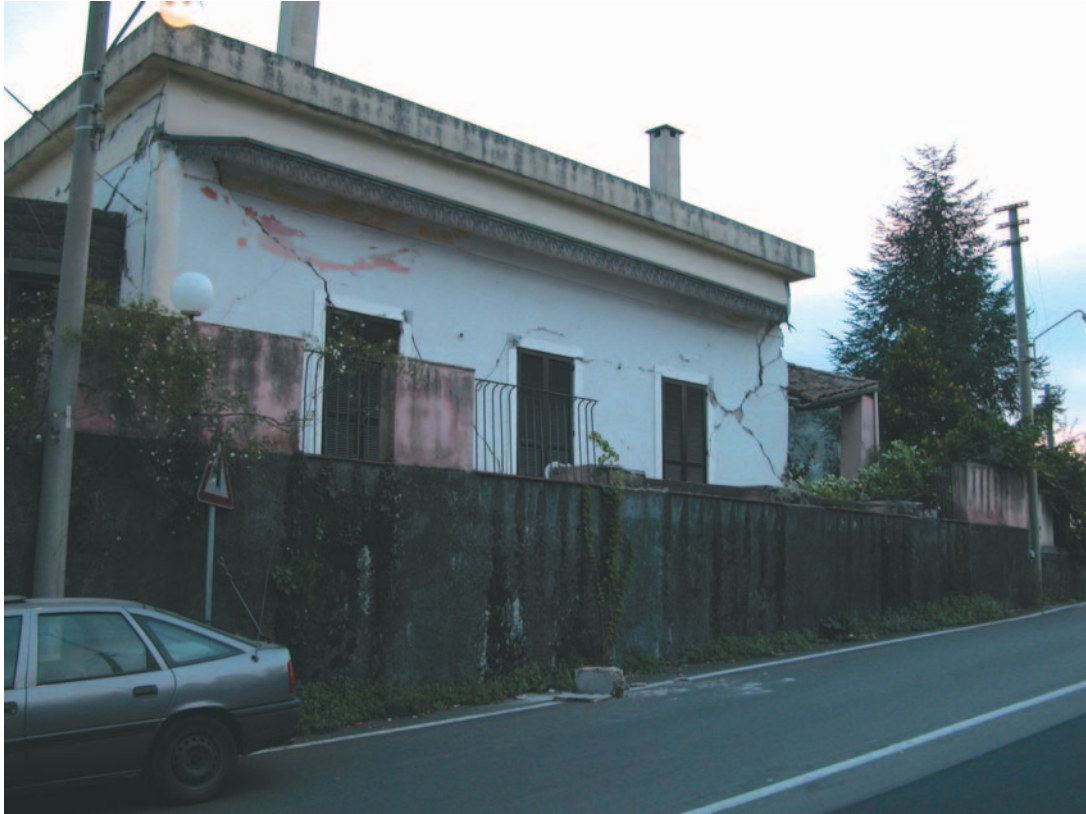
Foto 1.5 S. Venerina, periferia sud: lesioni a croce di S. Andrea in un edificio in muratura.
