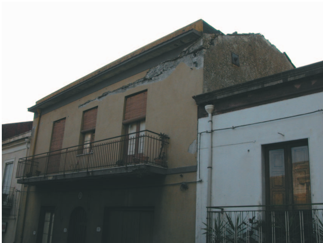
Foto 1.14 Zafferana Etnea: rottura dell'angolata muraria e del tetto per l'azione spingente delle coperture.
