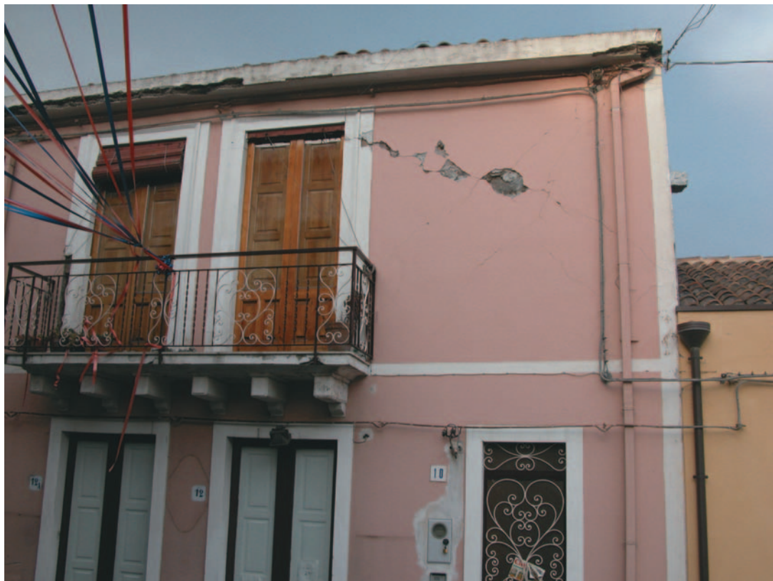
Foto 1.13 Milo: lesione passante nella facciata di un edificio in muratura.
