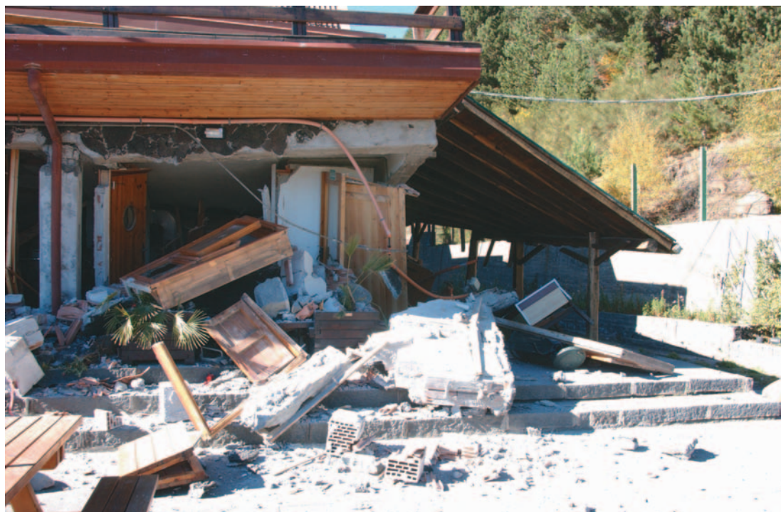
Foto 1.3 Piano Provenzana: particolare del danno alla struttura del Ristorante La Provenzana (foto F. Villa).
