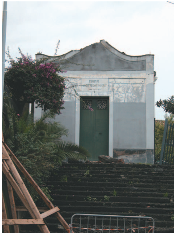
Foto 1.12 Scillichenti: danni gravi alla chiesetta del Calvario.
