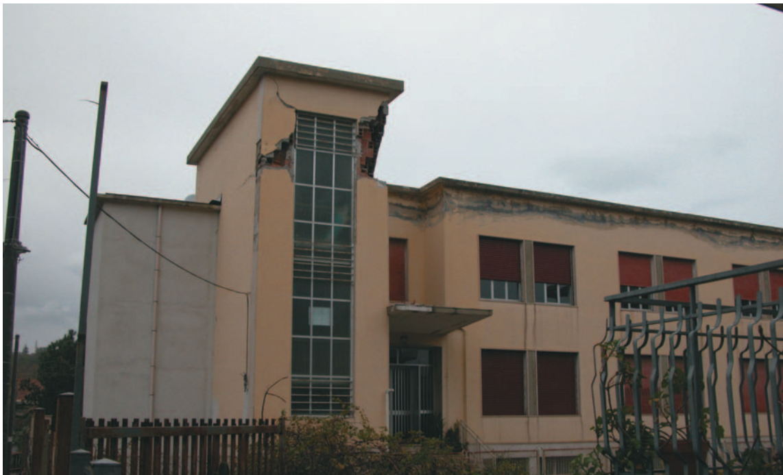
Foto 1.15 Macchia di Giarre: danneggiamento all'edificio della scuola elementare.
