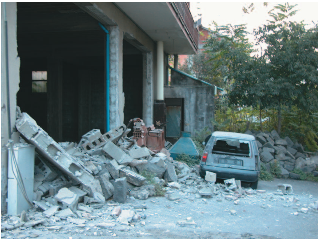
Foto 1.7 Crollo di tramezzi in edifici in c.a. in località Scura (Guardia, in alto) e in località Felicetto (Linera, in basso).
