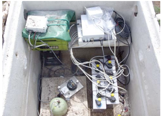
Stazione ATFO - Pozzetto con sensori, batterie e regolatore di carica
