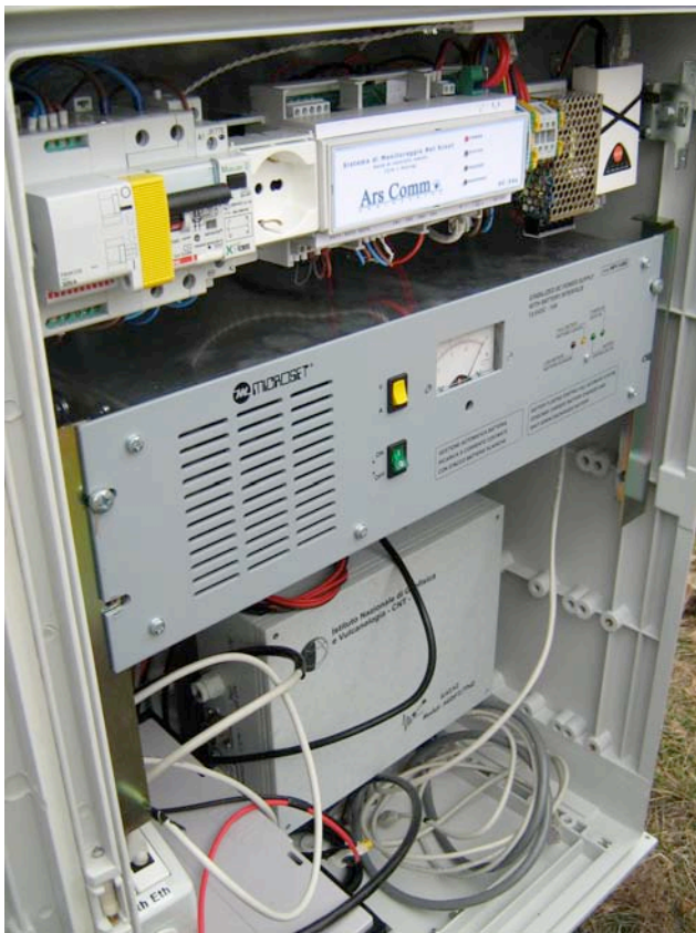
Nodo di Monte Cedrone - Sistema di alimentazione con UC34a, switch, Batteria tampone e GAIA_II nel nodo con alimentazione di rete
