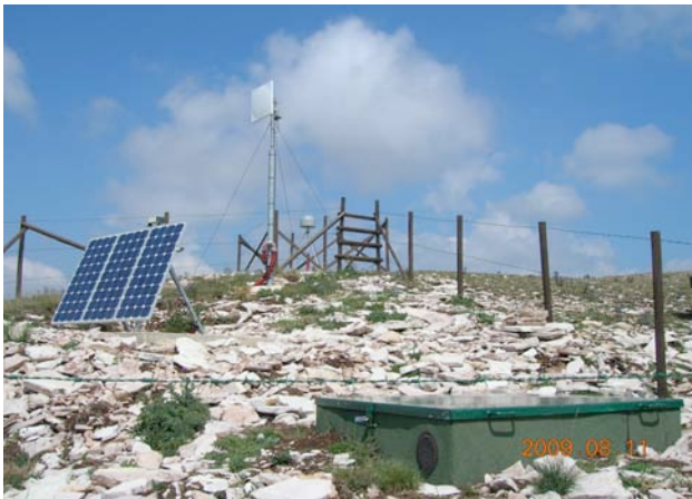
Stazione sismometrica e GPS di Monte Foce (ATFO)
