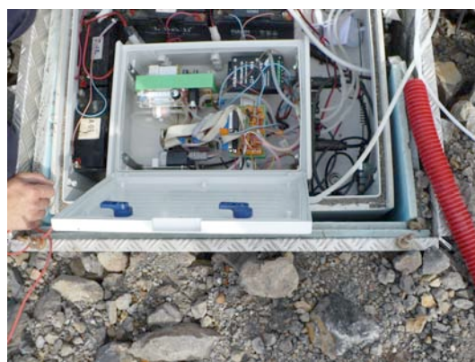
Figura 8. Particolare della stazione di monitoraggio.
