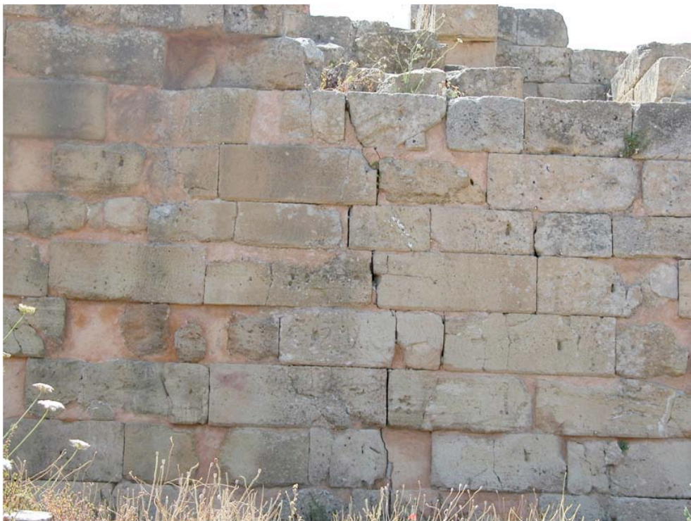
Figura 9. Punto di misura 24: cinta muraria dell'Acropoli, lato est: esempio di restauro moderno ove si è utilizzata malta (in rosa) per ricostruire il volume dei conci. Si nota una evidente frattura longitudinale che intacca il restauro attuale.
