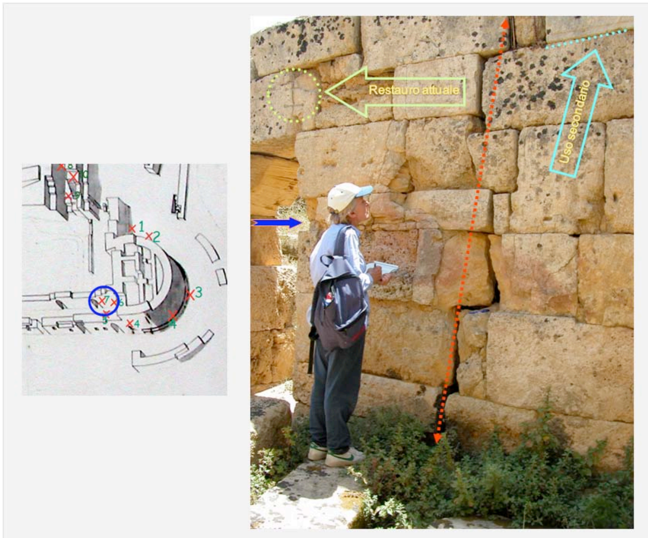
Figura 10. Punto di misura 7: momenti della raccolta dati all'interno del corridoio della grande galleria. La Dott.ssa Jacoli analizza il tipo di frattura e lo stato di spostamento dei conci dalla loro originaria posizione (freccia-tratteggio rossa). Si evidenziano, inoltre, moderne staffature in ferro (cerchio verde) e l'uso secondario di alcuni conci che conservano ancora tracce di decorazione incisa, probabilmente posti a sostituzione di alcune porzioni lesionate e/o mancanti del muro (tratteggio celeste).
