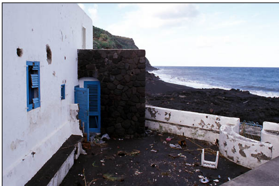
Figura 1. Danni provocati dal maremoto a Stromboli (foto del 04/01/2003).
