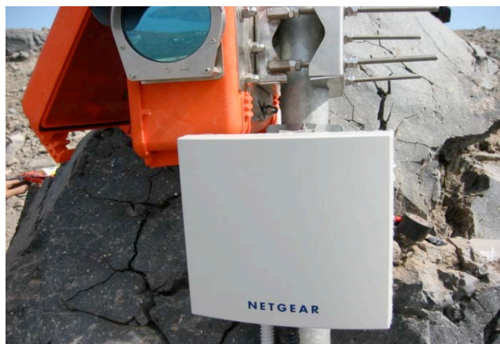
Fig. 8. Antenna direttiva installata a Vulcano per la trasmissione wi-fi con Lipari.
