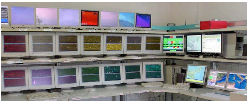
Fig. 1. Foto della Sala Operativa.
